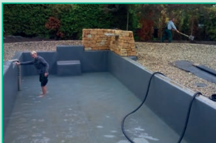
Der Schwimmteich im Bau mit dem Schwimmbecken in der Mitte. Der Randbereich mit Kies wird zur späteren Filterzone
